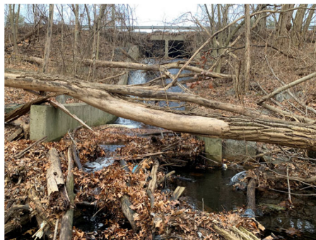
Conducto de aliviadero con árboles caídos que necesita reemplazo
